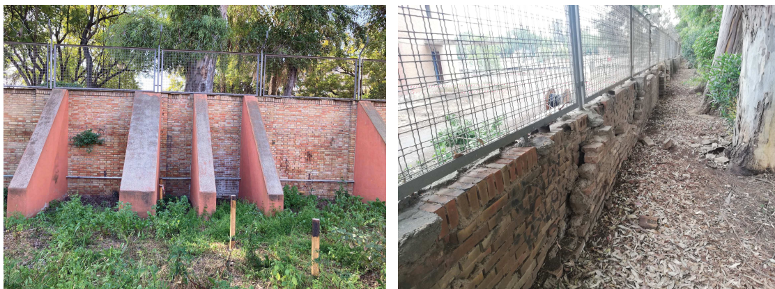
Fotografías del estado actual del muro de contención de los jardines Manuel Arellano y sus contrafuertes
