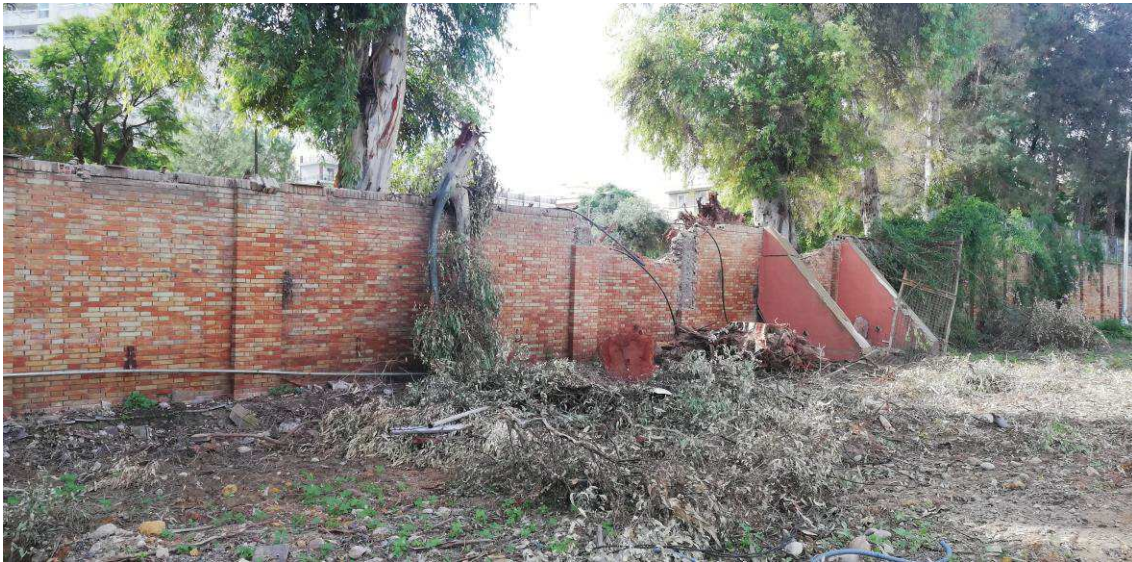
Estado del muro de contención en la zona afectada por la caída de los árboles de los jardines Manuel Arellano. Fotografías tomadas el 16 de noviembre, tras la retirada de los árboles caídos.
